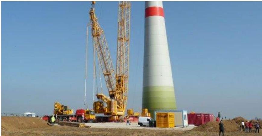
Im Frühjahr 2012 wurde das Windrad der Energiegenossenschaft Ingersheim aufgestellt Bild: © EG Ingersheim
